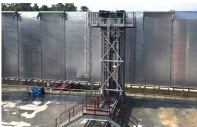
Einsatz von Rolltoren in einem Einzelkammersystem
